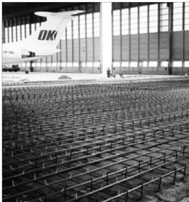
Напольное отопление для промышленных зданий
